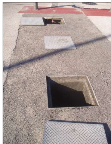
Decantadors de sòlids
